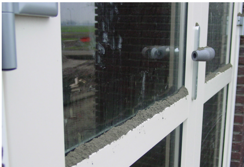
Figuur 26 — Foto met specieresten op/in de kitvoeg van de glassponning
