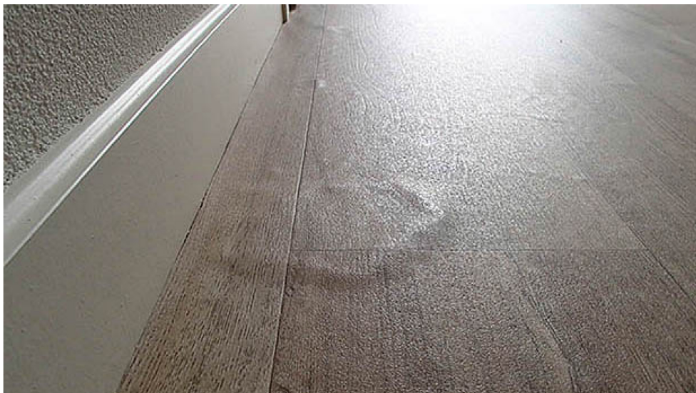
Figuur 9 — Bouwvocht in vloerafwerking (Bron: www.bouwtotaal.nl )
