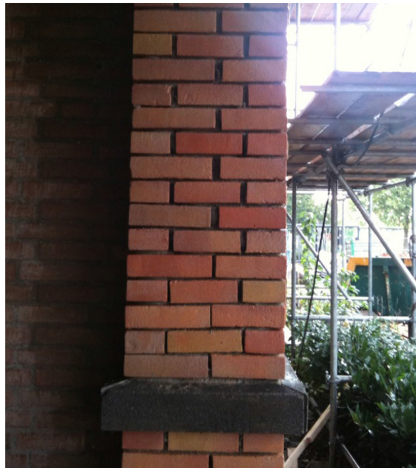
Figuur 43 — Slordig uitgevoerd metselwerk
