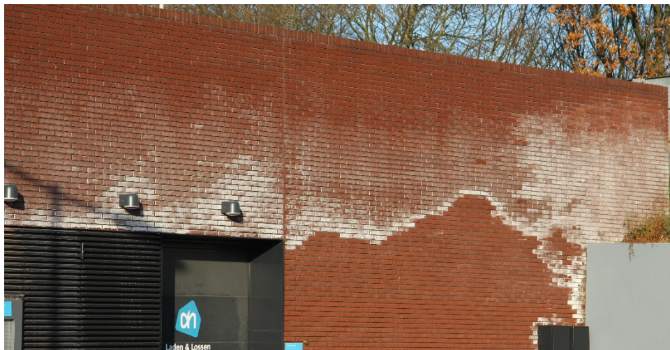
Figuur 42 — Voorbeeld witte uitslag ('uitbloei') op metselwerk (Bron: https://www.bouwwereld.nl/bouwfouten/witte-uitslag/ )
