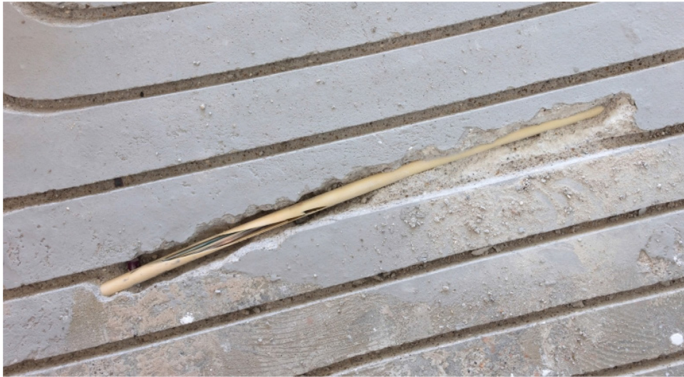
Figuur 10 — Voorbeeld van een elektriciteitskabel die is geraakt tijdens het infrezen van de vloer voor vloerverwarming
