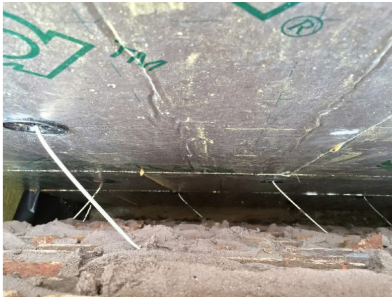
Figuur 32 — Voorbeeld van foutieve plaatsing
