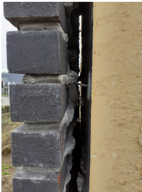
Figuur 31 — Voorbeeld van foutieve plaatsing spouwanker
