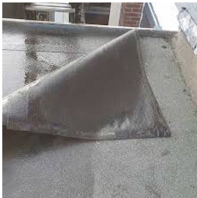
Figuur 48 — Voorbeeld van dakbedekking die niet goed is bevestigd en is losgetrokken door de wind
