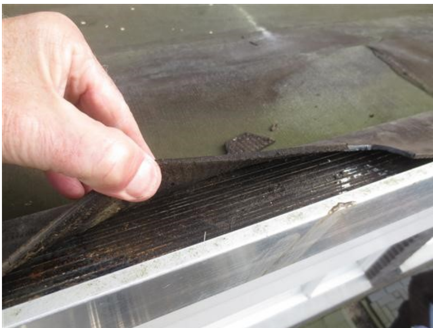
Figuur 49 — Windschade omdat de dakbedekking opwaait
