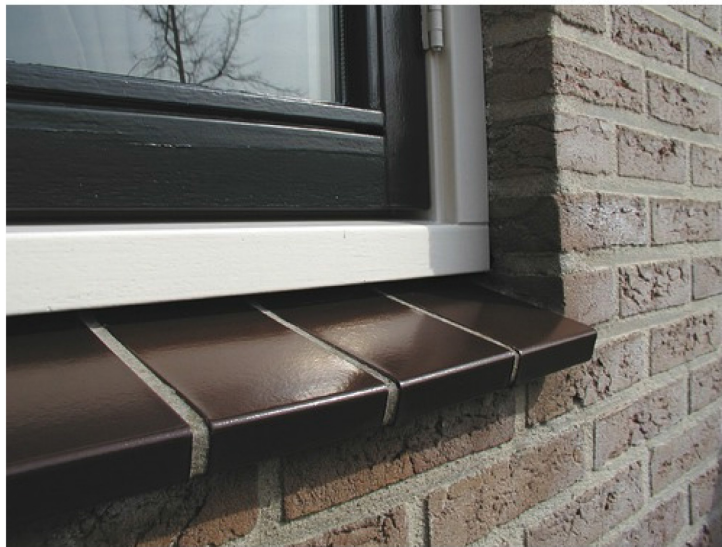
Figuur 39 — Voorbeeld van goed en deugdelijk aangebrachte raamdorpel
