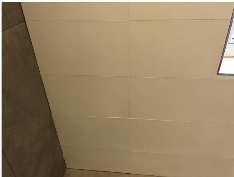
Figuur 13 — Voorbeeld van onjuist geplaatst tegelwerk met hoogteverschil
