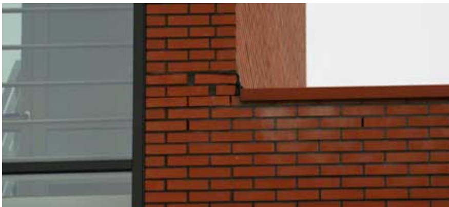
Figuur 34 — Asymmetrische voegen in het metselwerk (Bron: https://www.bouwwereld.nl/bouwfouten/gevel-metselwerk/ )
