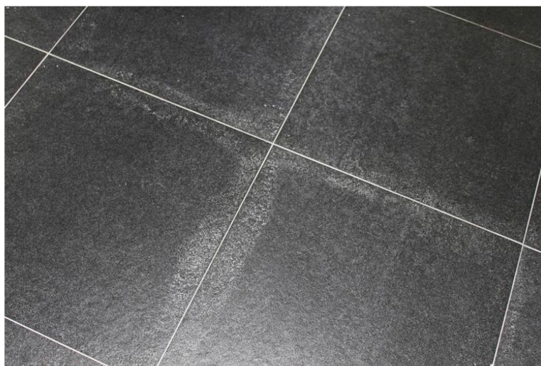
Figuur 14 — Voorbeeld van niet schoongemaakte tegels waarbij de cementsluier zichtbaar is
