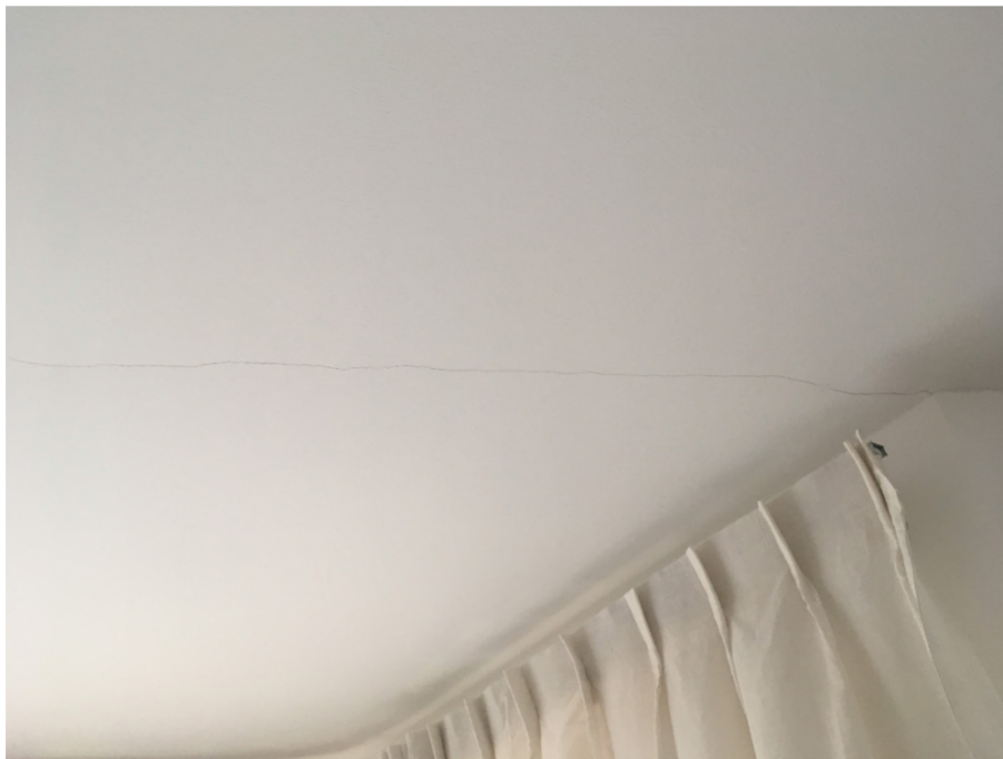
Figuur 18 — Voorbeeld van een haarscheur in een plafond
