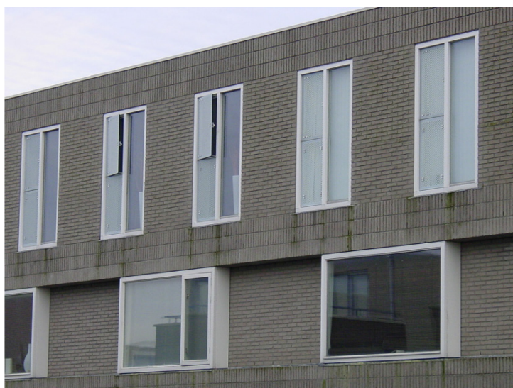
Figuur 38 — Voorbeeld van ontbreken van raamdorpel onder de raamkozijnen (Bron: privéarchief van voormalig bouwkundig adviseur bij Woningborg)
